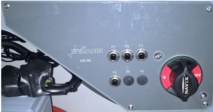
Pääkytkin ja sulakkeet.
